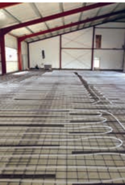
Gute Wärmeverteilung dank Betonkernaktivierung
