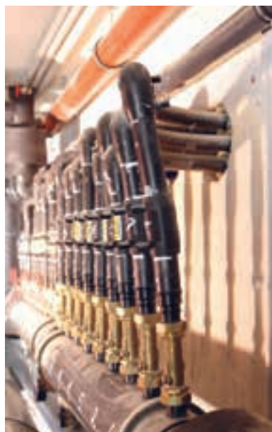
Geothermie-Anlage: Scho- nung wertvoller Ressourcen und Reduzierung des CO 2 -Ausstoßes
